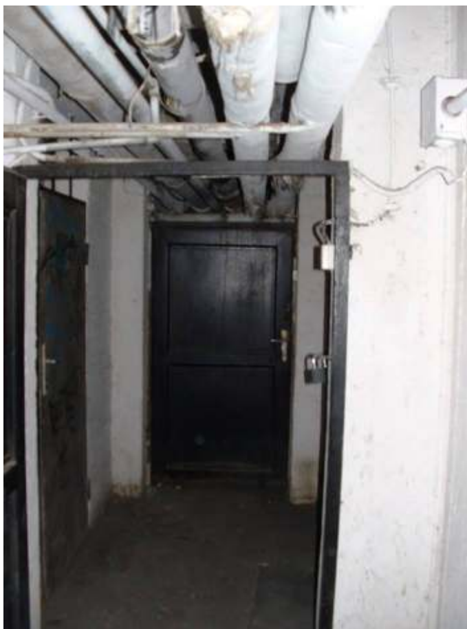
21. A pincszinti tárolók közötti folyosó, háttérben a szomszéd fogatba vezető ajtó, fölötte térelhatárolás (így tűzállósági határérték) nélküli gépészeti vezetékháttörésekkel (fotó: Takács Lajos Gábor)
