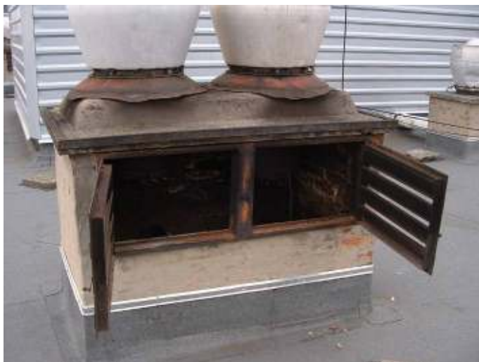
18. A szellőztető berendezés gravitációs elvezető nyílása a fix zsaluval (fotó: Takács Lajos Gábor)
