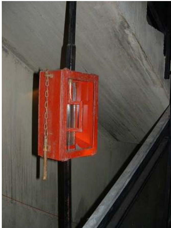
17. A hő- és füstelvezető ablak nyitószervezete (fotó: Takács Lajos Gábor)
