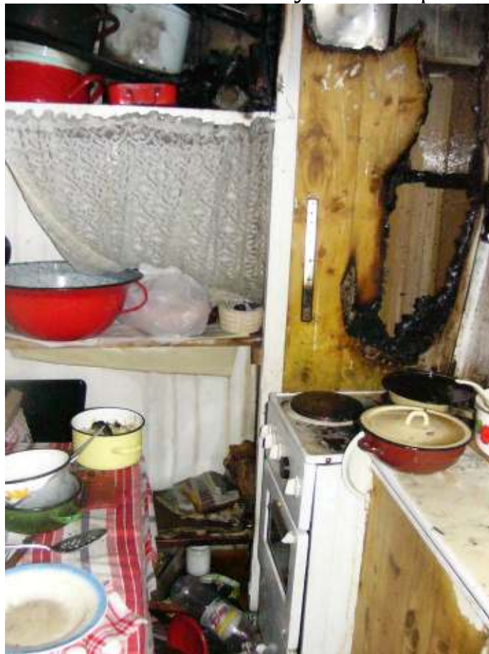
2. A Fényesudvar 6. sz. alatti lépcsőház földszint 2 sz. lakás konyhája, a tűzhellyel és a szagelszívó akna éghető burkolatával, amely elsőként gyulladt meg (fotó: Debreceni Hivatásos Önkormányzati Tűzoltóparancsnokság)
