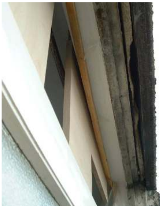
15. A X. emelet 42 sz. lakás félszobája fölötti attika hőszigetelésének károsodása (fotó: Takács Lajos Gábor)
