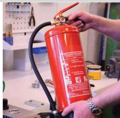
Karbantartott készülék végső szemrevételezése
