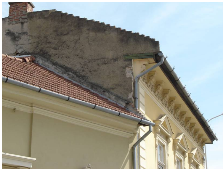
Tetőszinti tűzterjedés elleni gát ereszminti tűzterjedés elleni gáttal és alsó nádszövet erősítésű vakolatos eresztűzvédelemmel (Eger)
