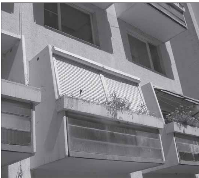
Hibás gyakorlat: Függeszettten csatlakoztatott erkélyek: tűzterjedési és tűzállósági probléma
