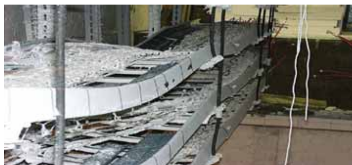
Vizsgálat során deformálódott kábelrendszer: A deformáció a megerősített kialakítás ellenére is jelentős
