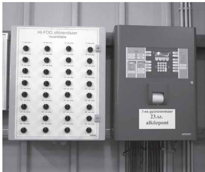
Oltórendszer vezérlőtábla és tűzjelző alközpont
