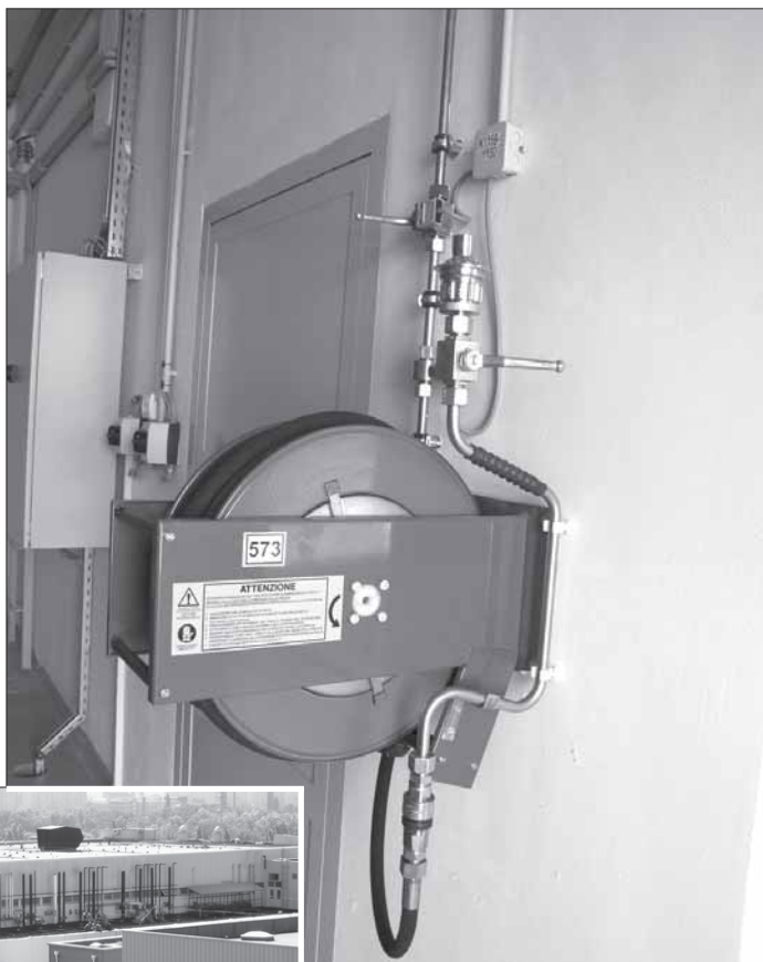
Magasnyomású tűzcsap az új épületekben
