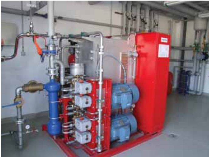
Magasnyomású HI-FOG vízköddel oltó védi az új épületeket és a kábelcsatornát
