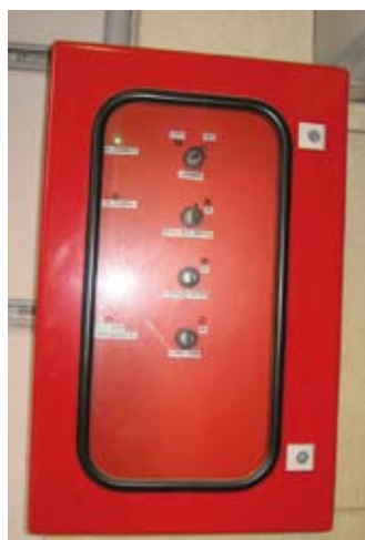
A bejárat közeliében elhelyezett oltóközpont (balra)
