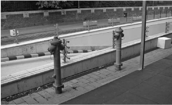
Tűzcsap és száraz leszálló vezeték
