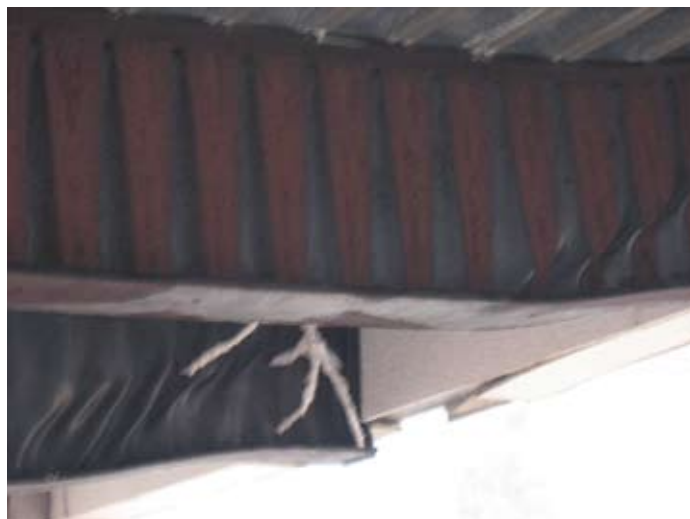
A megerősített acélgerendák deformálódása
