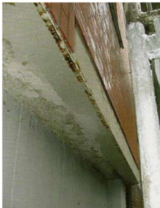
8-9. ábra. Nagytáblás kerámia burkolatok helytelen kivitelezésének eredményei
