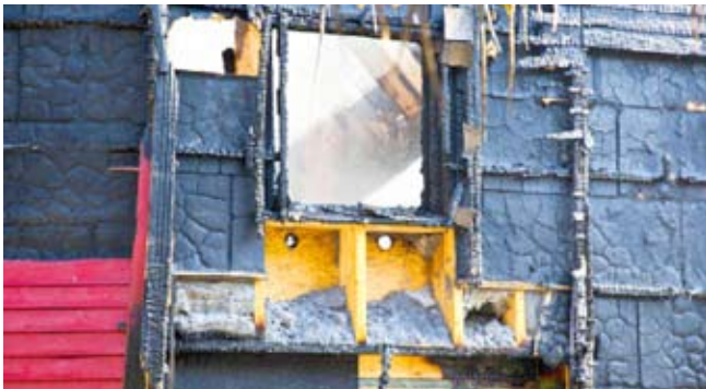
10-11. képek. Különböző mértékű károsodások a freiburgi könnyűszerkezetes alacsony energiaigényű óvoda tüzesetét követően, az ablakok körül. Jól látható, hogy a belső tűz a homlokzatra az ablakokon keresztül lép ki, ezért az ablak körül, illetve fölött a legnagyobb mértékű a károsodás
