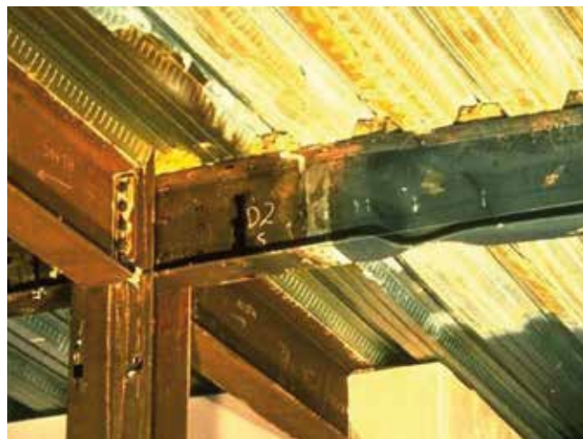
5. ábra. Övlemez horpadása a befogott tartóban
