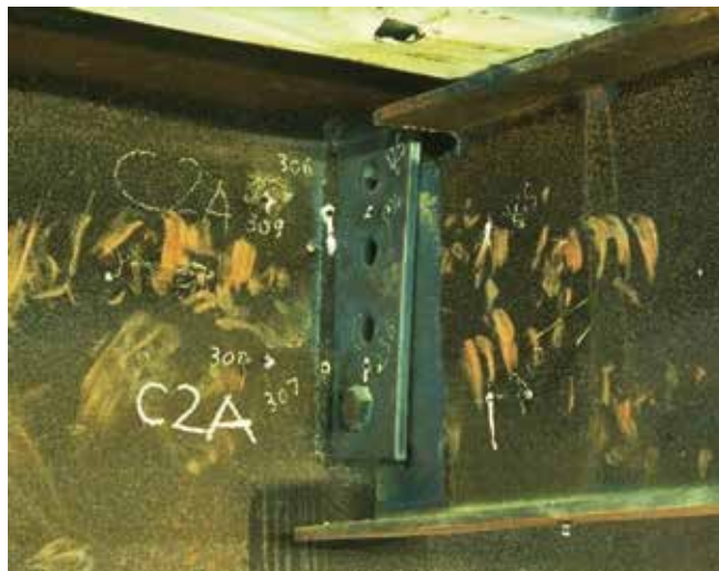
8. ábra. Gerincbekötő lemez a tesztet követően
