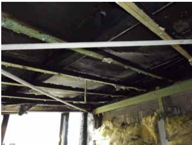
A POLISZTIROL KIÉGETT, S A SZÁLAS HŐSZIGETELŐ ANYAG IS SÉRÜLT
