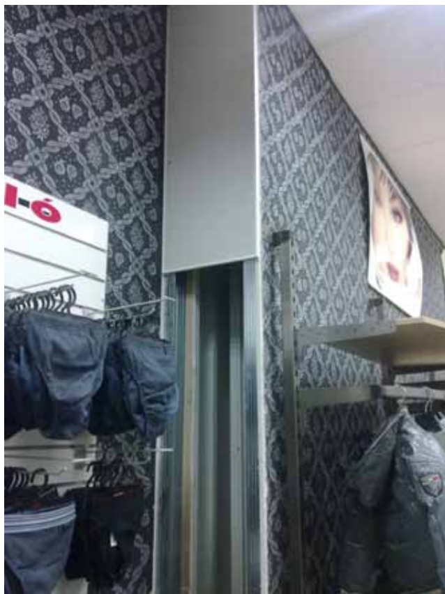
BEVÁSÁRLÓKÖZPONT TŰZSZAKASZ-HATÁRÁN TŰZGÁTLÓ TOLÓKAPU ZÁRÓSÚLY SEBESSÉG-SZABÁLYOZÓJÁNAK KARBANTARTÁSA
