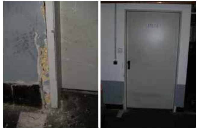
SAKSZERŰTLENŰL BEÉPÍTETT, PUR HABBAL RÖGZÍTETT TŰZGÁTLÓ AJTÓ ÉS KÁROSODÁSA
