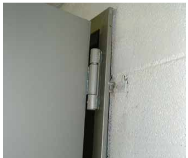
SAKSZERŰTLENŰL BEÉPÍTETT TŰZGÁTLÓ AJTÓ
