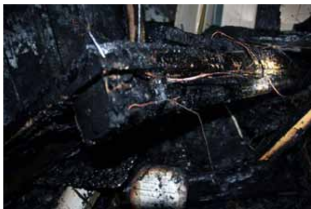
A FASZERKEZETHEZ SZABÁLYTALANUL RÖGZÍTETT, ILLETVE AZON SZABÁLYTALANUL ÁTFÚRT ELEKTRO- MOS VEZETÉKEK
