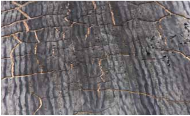
QUADCORE KORMOZÓDÁS ÉS FELÜLETI REPEDÉSEK
