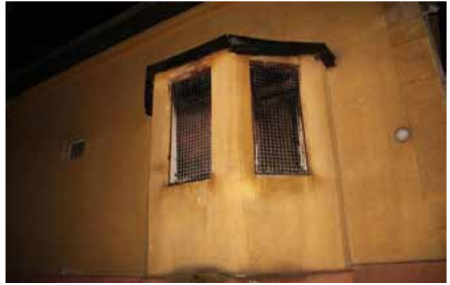
A TÓRASZEKRÉNY MÖGÖTTI, TŰZ SORÁN KÁROSODOTT ABLAKOK KÍVÜLRŐL FÉNYKÉPEZVE (ITT TÖRTEK KI A LÁNGOK AZ ÉPÜLETBŐL)
