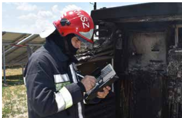
ÉLESBEN ALKALMAZÁS – MÓRAHALOM NAPEMPARK TRAFÓHÁZÁNÁL
