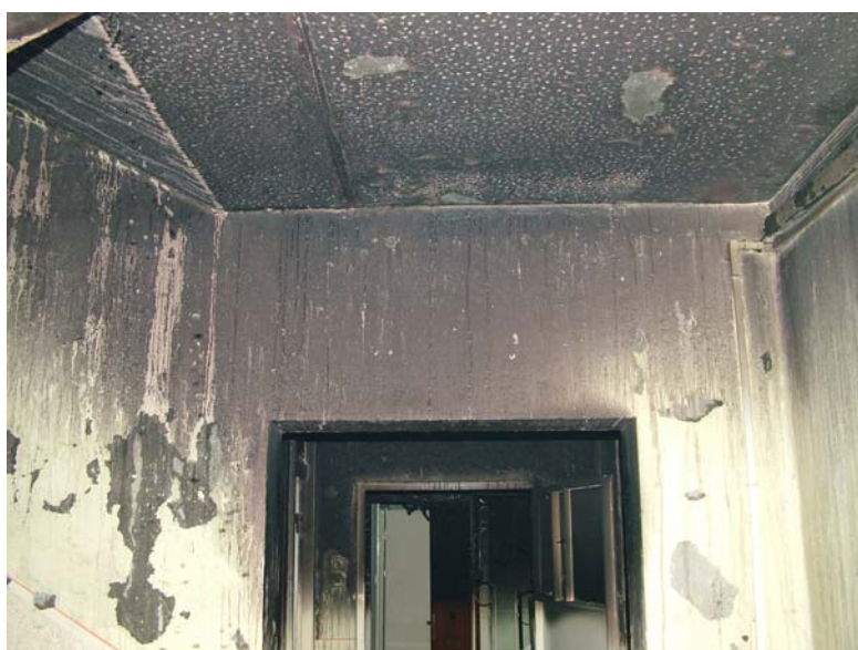
21. Első emeleti lépcsőház kormozódása, intenzív hő és füstthatás.
