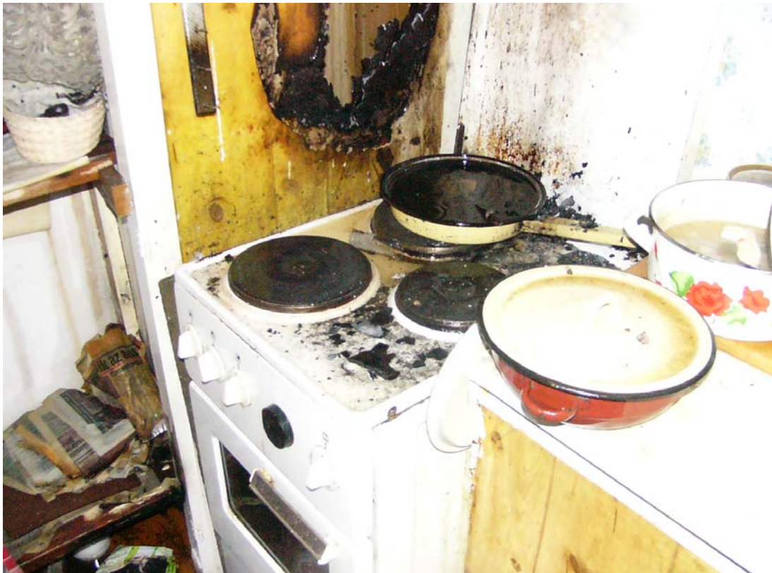
18. Földszint 2. –a tűz keletkezésének helye.
