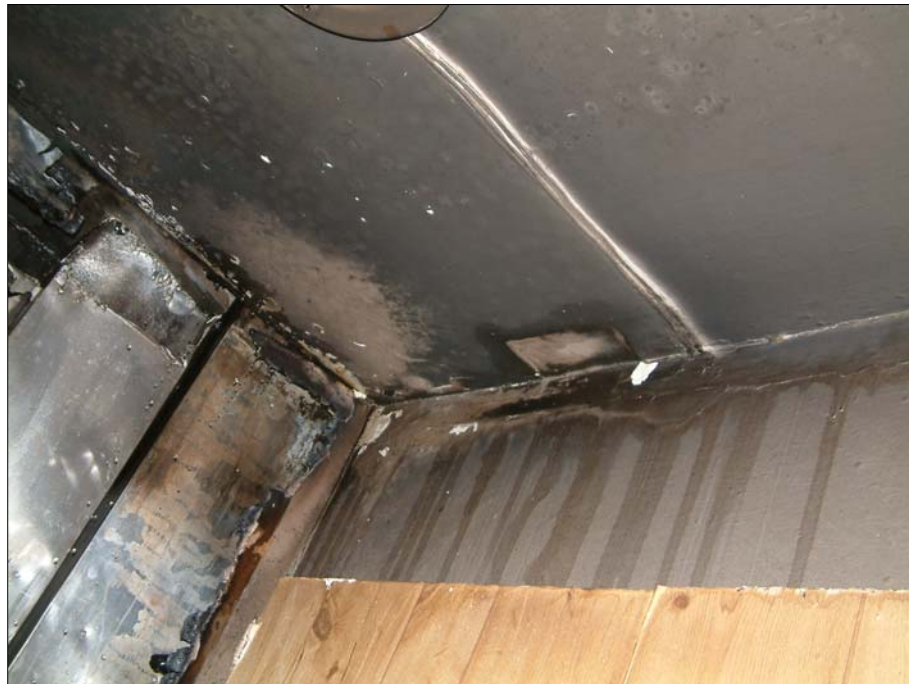
22. Földszint 2-a villanytűzhely melletti szellőzőrendszer.
