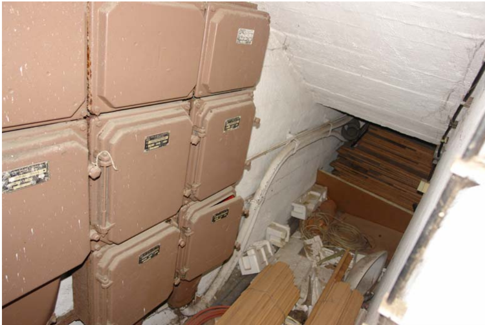
55. A Fényes udvar 6. szám alatti, alagsori elektromos elosztó helyiség, a benne tárolt éghető hulladékokkal.
