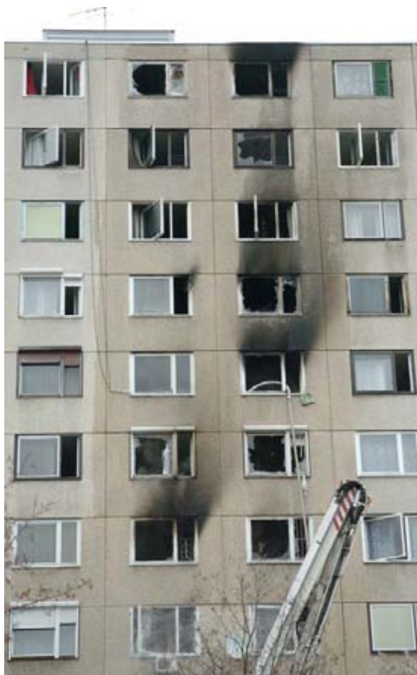
11. A kiégett eloltott épülettömb, déli homlokzata. Jellegzetesen megfigyelhető a tűz terjedése. Jellemzően azok a szobák égtek ki, ahol az ablak nyitva volt.
