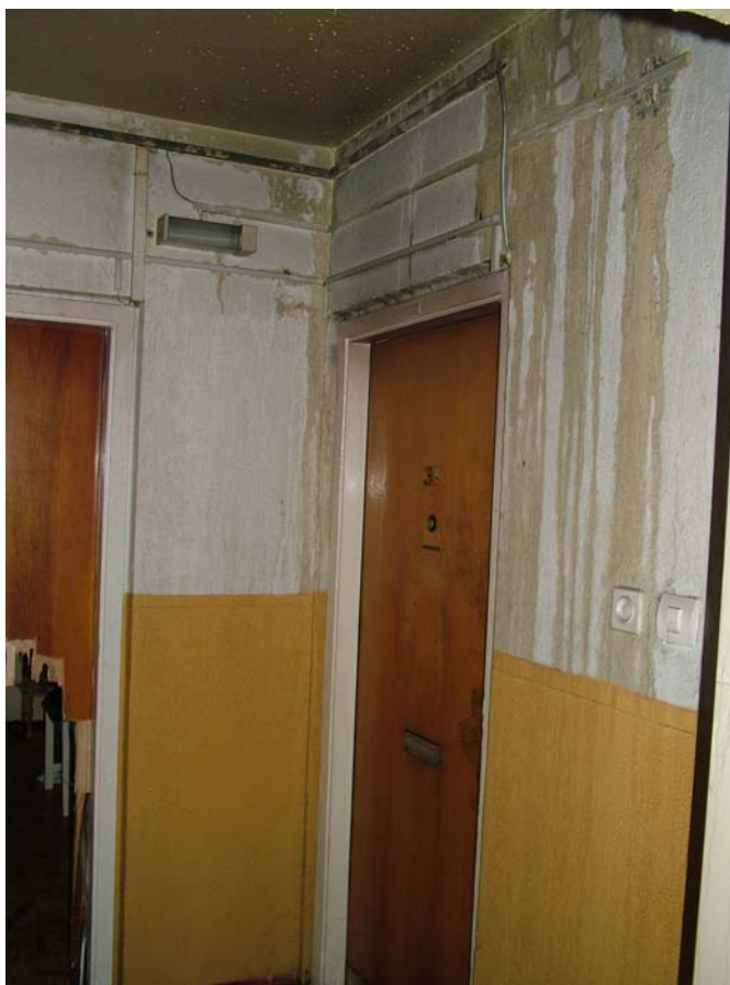
42. Nyolcadik emeleti közlekedő. Sértetlen a másfélszobás bejárati ajtó.
