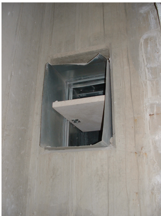
1 sz. kép. Tűzcsappantyú gépészeti aknacsatlakozása kibontást követően. A mechanikai sérülést egy, az aknába az építés alatt beejtett zsalukő okozta, amely az aknán kívül nem látható
