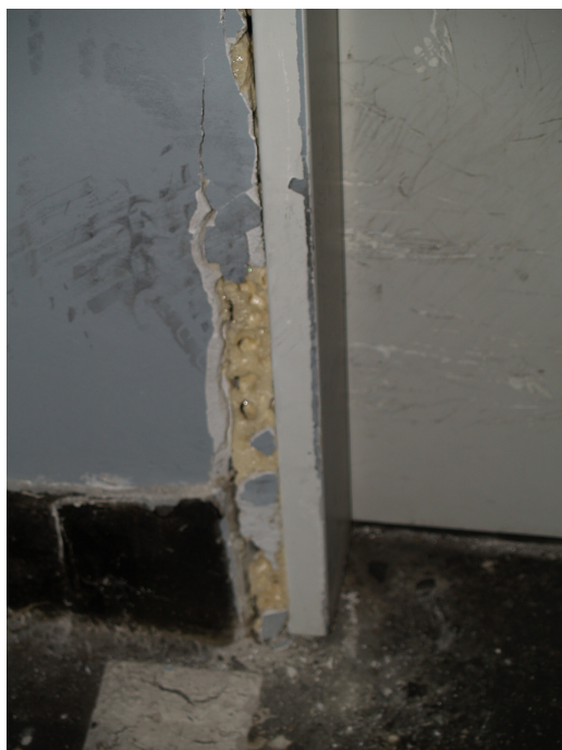
2 sz. kép. Tűzgátló ajtó szakszerűtlen beépítése – napjainkban a tűzgátló ajtók többségét is poliuretán habbal rögzítik vagy tömítik amely még az ajtók nagy tömegéből adódó igénybevételeket sem bírja
