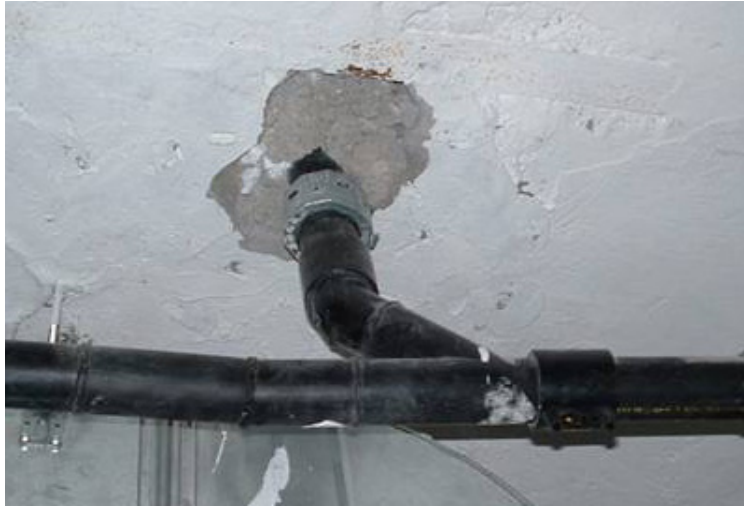
5 sz. kép. Tűzvédelmi mandzsetta a födém helyett a csatornavezetékre rögzítve – így a csatornavezetékkel együtt szakad le, illetve sérül tűz esetén
