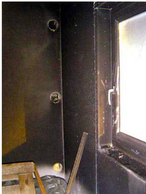
9 sz. kép. Homlokzati fal belső részlete a tűz után
