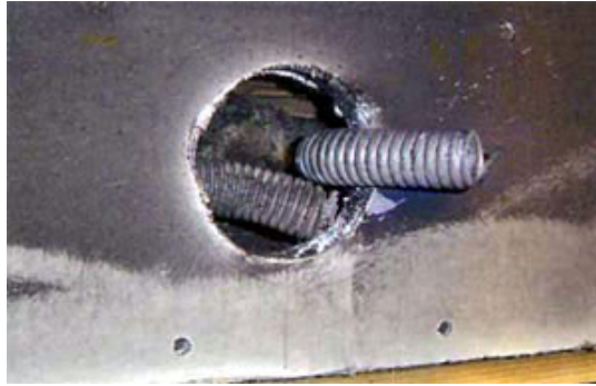
8 sz. kép. Elektromos dugalj közelképe. Jól látható, hogy a dugalj mögött nincs ún. tűzvédelmi doboz, amely a gipszkarton lemez megszakításánál megakadályozná a tűzterjedést
