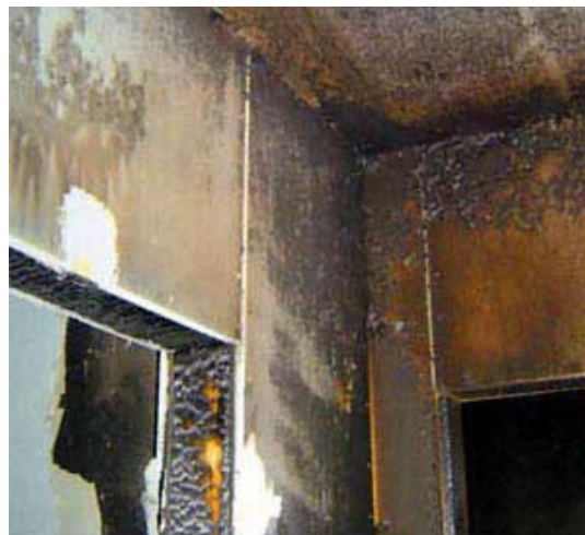
7 sz. kép. Szobasarok részlete a tűz után. Jól látható a falnyílások körüli faszerkezet elszenesedése
