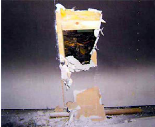
6 sz. kép. Tűzterjedési nyomok a gipszkarton burkolat mögött, amelyek csak a burkolat megbontásával láthatóak
