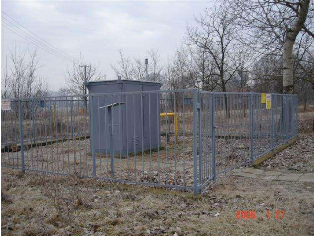
4. ábra Gázfogadó állomás
