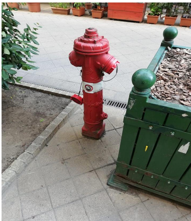
10. kép – Tűzcsap kifolyócsonkját akadályozó fával beültetett utcabútor
