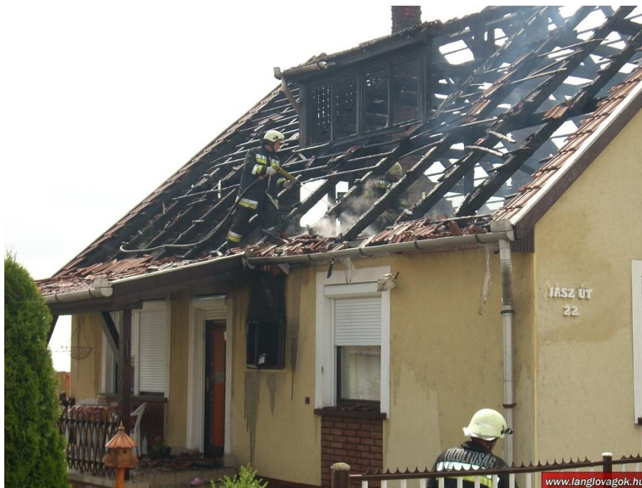
2.5. ábra – Villanyórában keletkezett tűz miatt leégett tetőszerkezet (forrás: langlovagok.hu)
