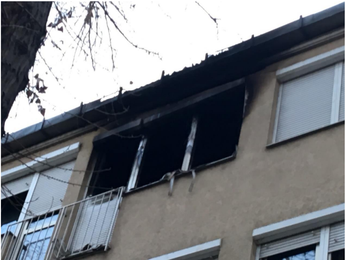
3.1. ábra – Ráday utcai kollégium tüzében károsodott ereszt (saját fotó)
