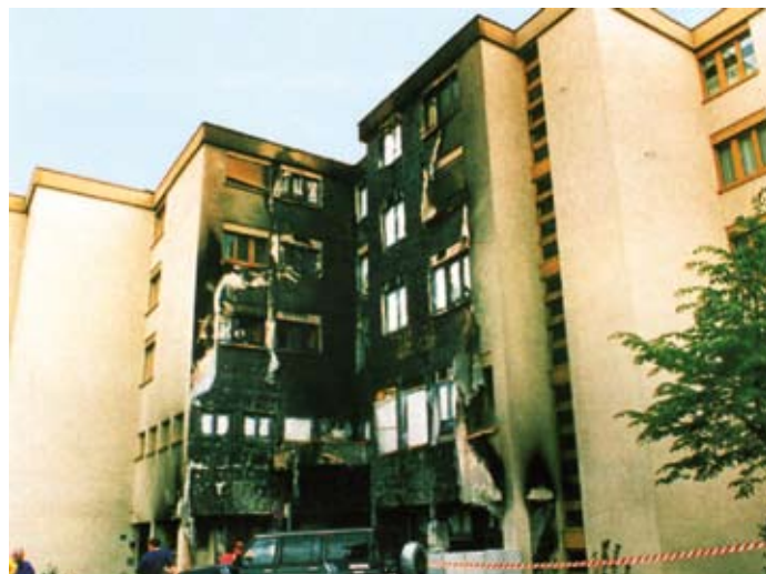
Egy kukatűztől leégett a homlokzati hőszigetelés
