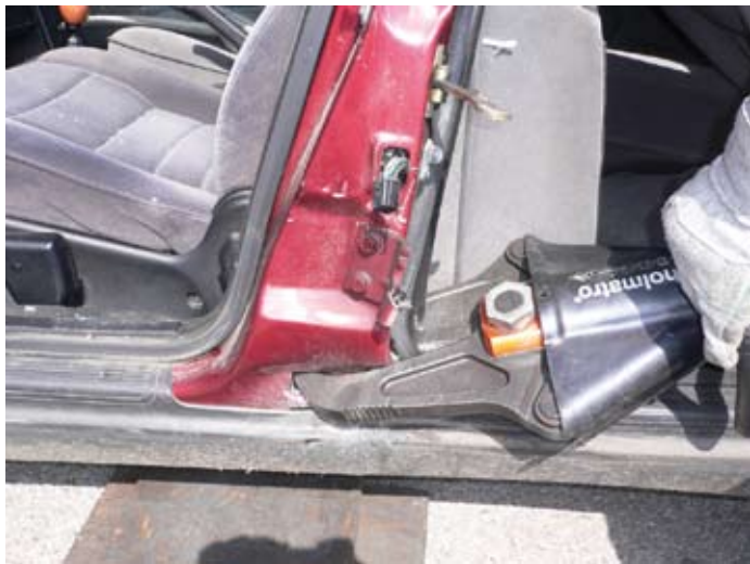
16. ábra. A „B” oszlop vízszintes bevágása
