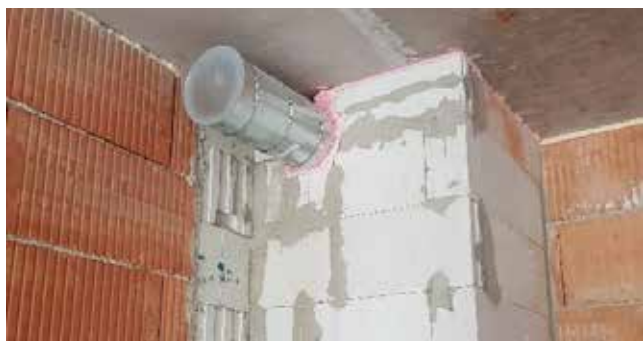
8. ÁBRA – SZABÁLYTALANUL BEÉPÍTETT CSAPPANTYÚBETÉT
