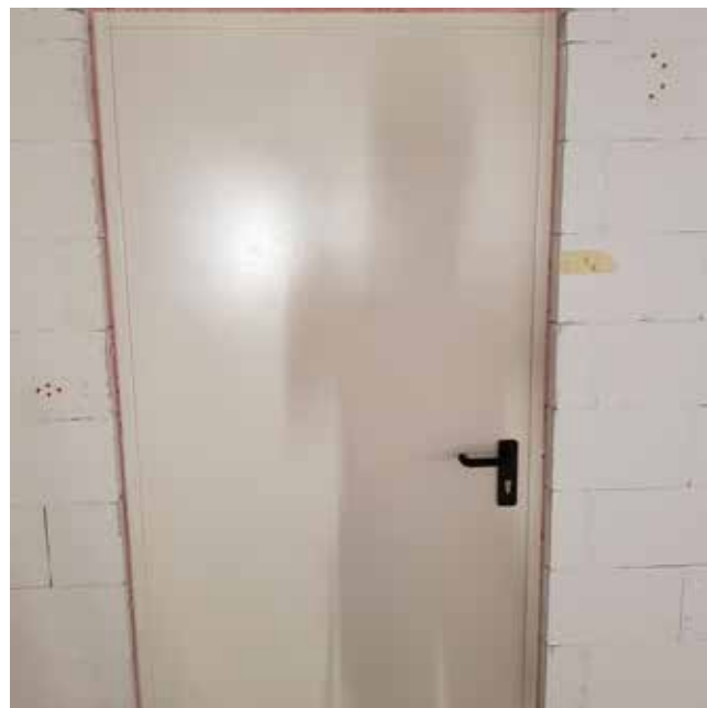
I. ÁBRA – PUR-HAB BEÉPÍTÉSIHÉZAG-TÖMÍTÉSSEL SZERELT TŰZGÁTLÓ AJTÓ – DE VAJON SZABÁLYOS-E A MINŐSÍTÉSE ALAPJÁN?
