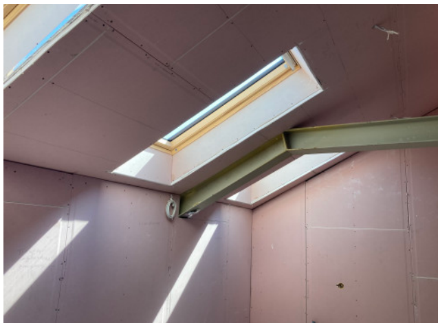
I. ÁBRA – TETŐTÉRKIÉPÍTÉS TÉRELHATÁROLÓ SZERKEZETE MEGFELELŐ VÉDELEM NÉLKÜLI VILLAMOS KIÁLLÁSSAL
