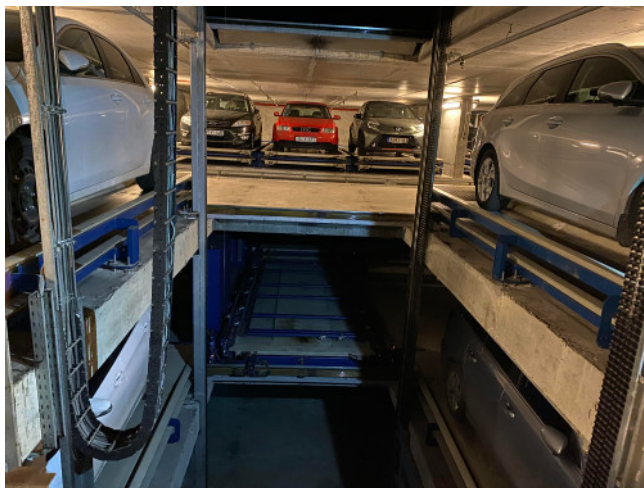
A LIFTAKNÁK KOMOLY VESZÉLYFORRÁST JELENTENEK
